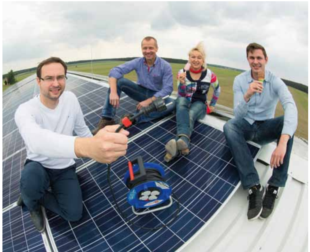
Die Firma Eis& Friends ließ auf ihrem Hallendach nicht nur eine Photovoltaikanlage installieren.
